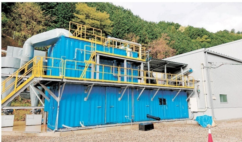
蒸気を発生させる小型回転型燃焼炉RPFボイラー。関市洞戸飛瀬、秋田屋フーズ洞戸工場
